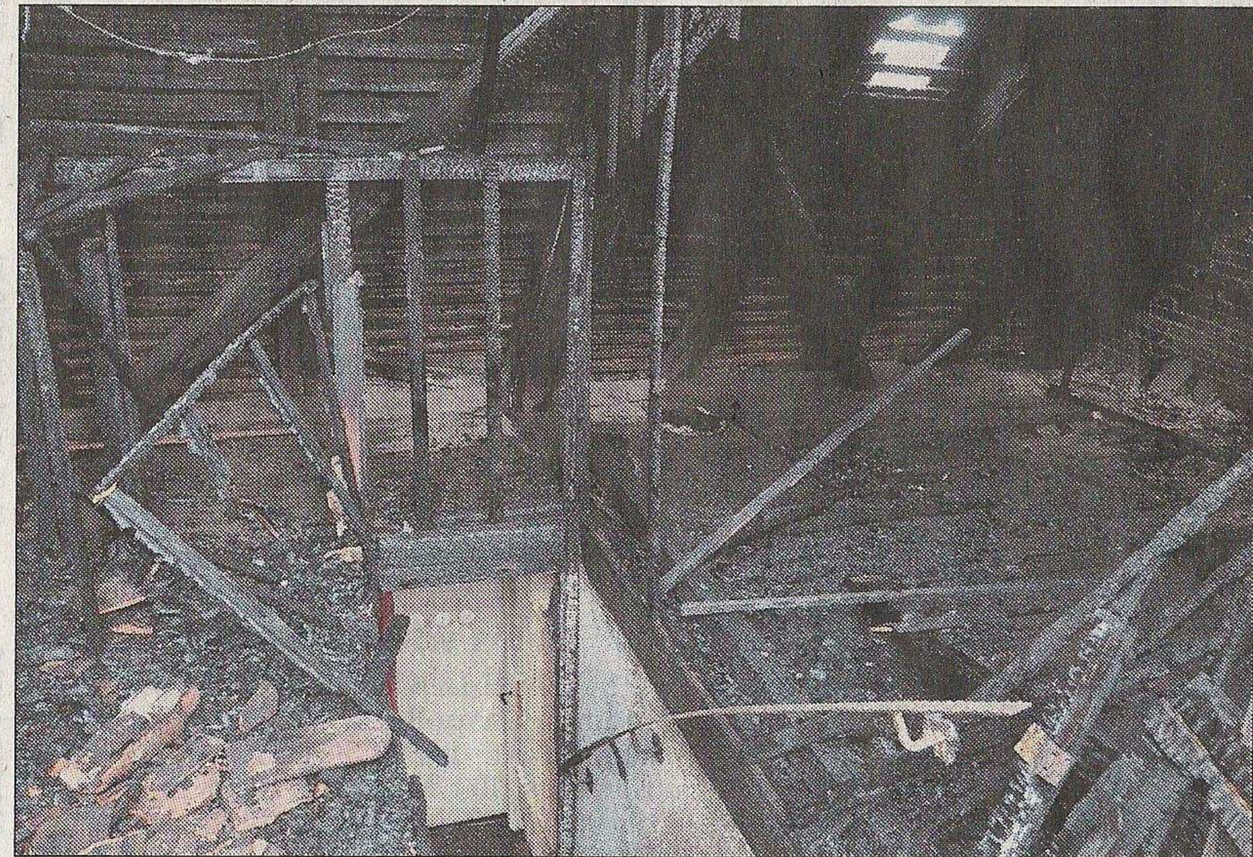
Fast das gesamte Gebälk des Dachstuhl ist verkohlt. Mit der Wärmebildkamera spürten die Feuerwehrleute immer wieder Glutnester auf. Fotos: Prüfer
